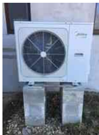
Hőszivattyús fűtési rendszer
